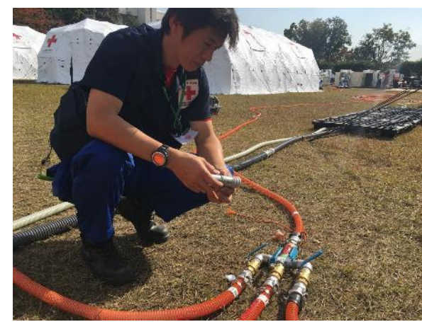
水・衛生設備
